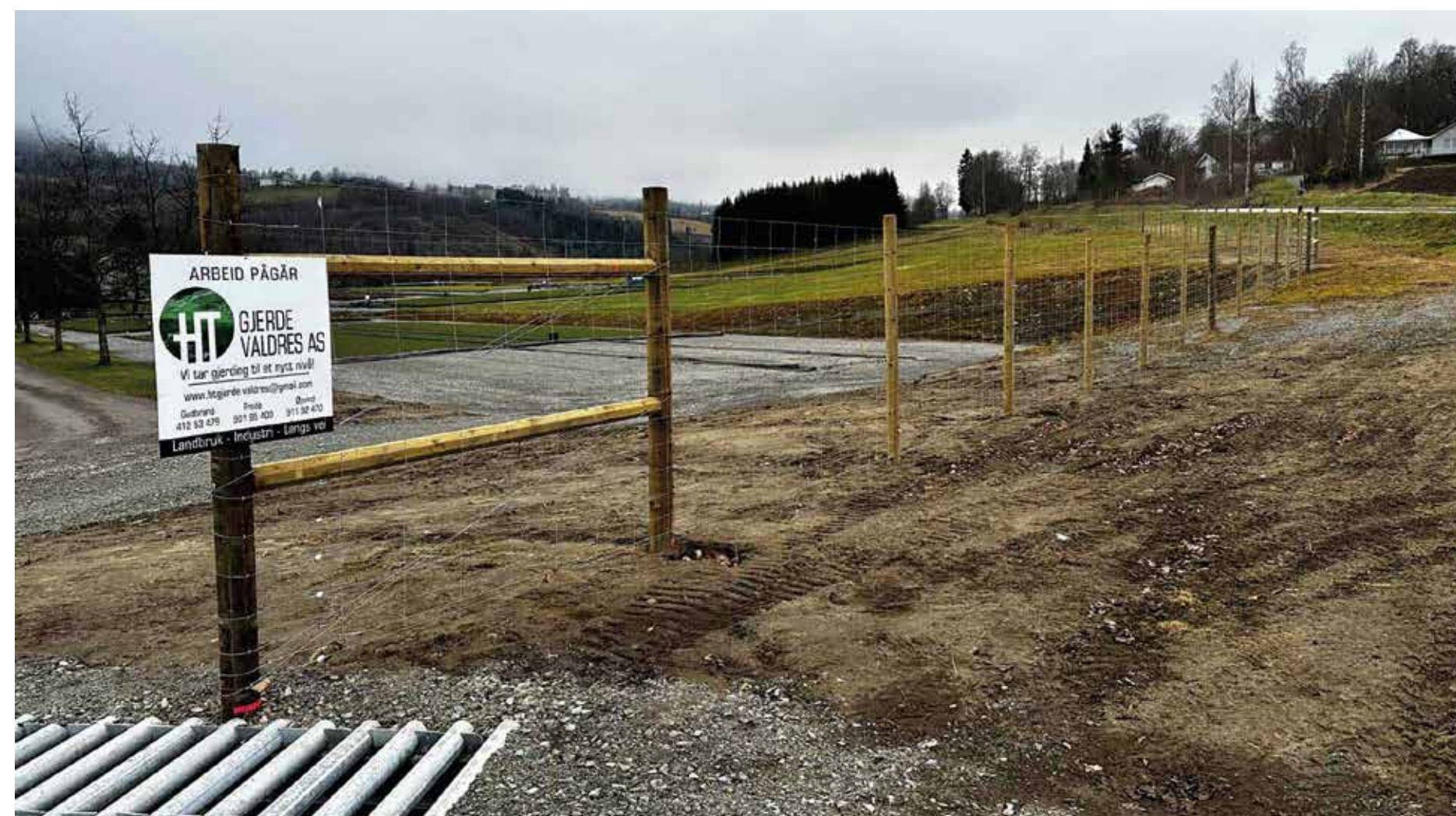
VILTGJERDE: I høst vil det stå et 1500 meter langt gjerde ferdig rundt Skogplanter Østnorge (planteskolen). Viltgjerdet vil beskytte plantene mot rådyr og elg.
